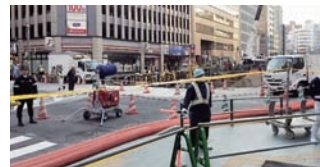
博多の道路陥没の現場
